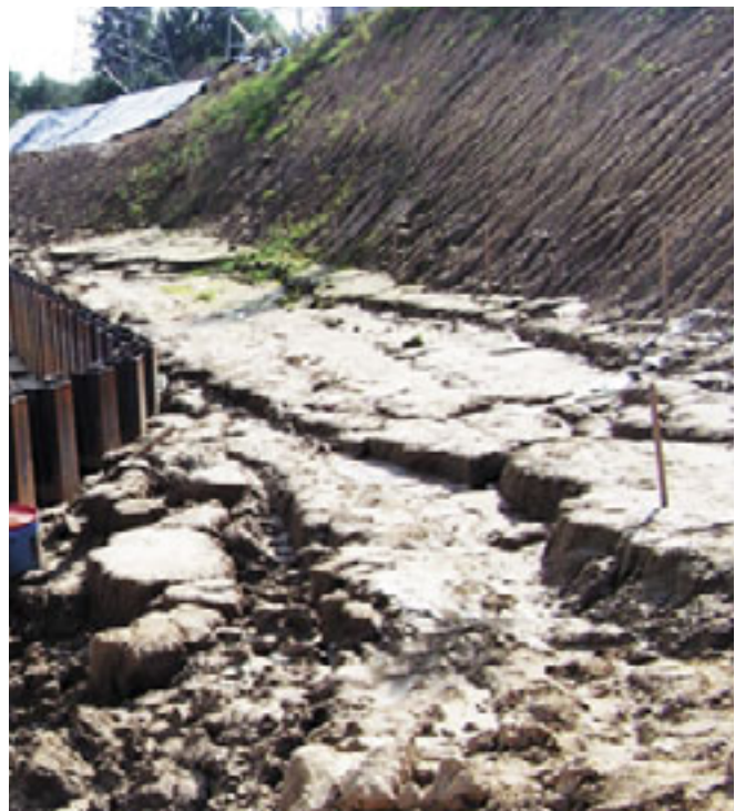
Fot. 4. Nieprzewidziane zjawisko osiadania
