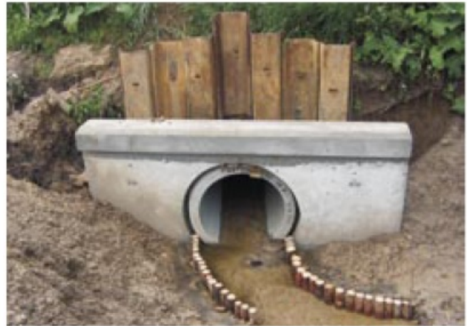
Fot. 6. Przepust z rur Betras o średnicy 1000 mm
