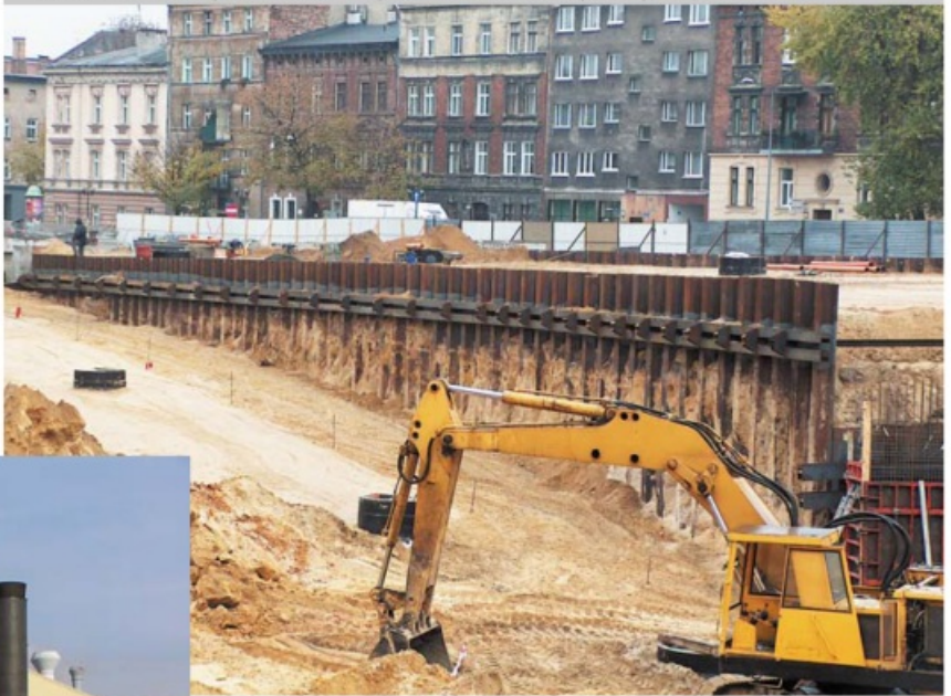
Fot. 6. Mur oporowy z grodzic stalowych PU – Budowa Trasy Galicyjskiej w Krakowie
