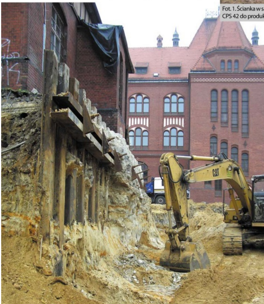
Fot. 2. Ścianka szczelna kotwiona – Budowa Centrum Nauki i Edukacji Muzycznej Symfonia przy ul. Damrota w Katowicach
