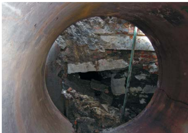
Fot. 3. Przeszkody napotkane na trasie przewiertu
