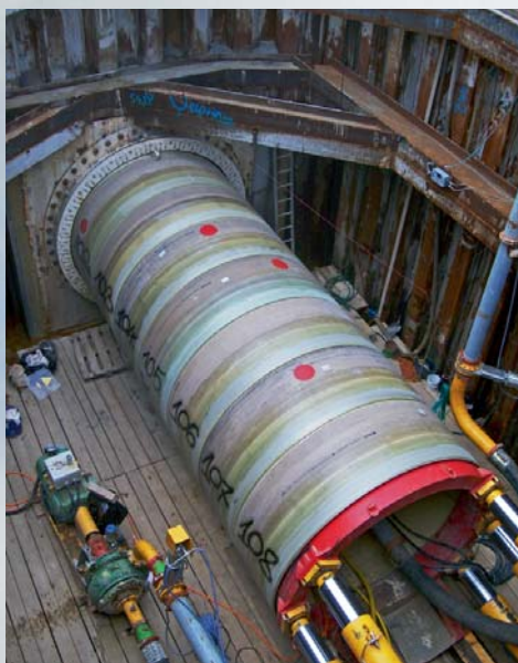
Fot. 1. | Komora startowa
