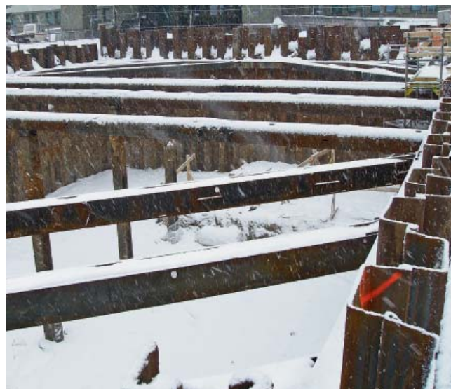
Fot. 3. | Rozparcie ścianek zbiornika
